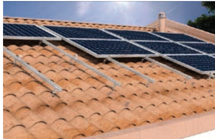
Estructura especial en cubierta coplanar
