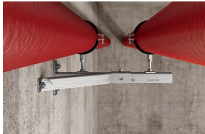
Arriostamiento de tubería con perfiles de carril
