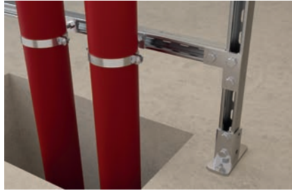
Tubería de aguas residuales
