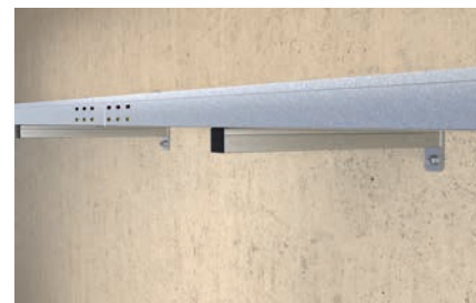
Bandeja portacables sobre ménsula
