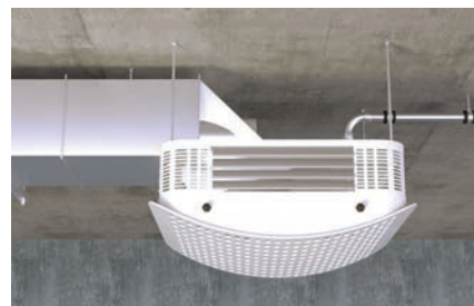
Unidades de aire acondicionado
