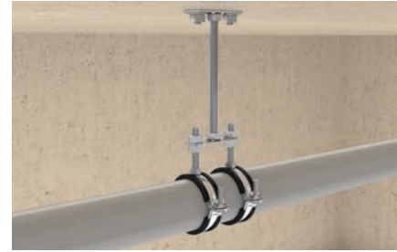
Tubería de plástico con instalación de punto fijo.
