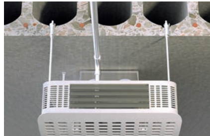
Unidades de aire acondicionado en núcleo hueco pretensado losas de hormigón
