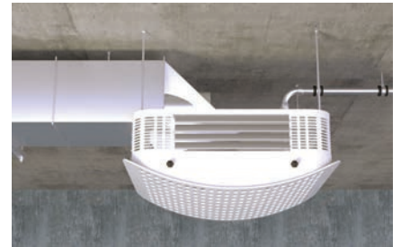
Unidades de aire acondicionado
