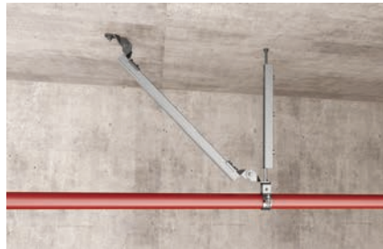
Arriostamiento de tubería con perfiles de carril
