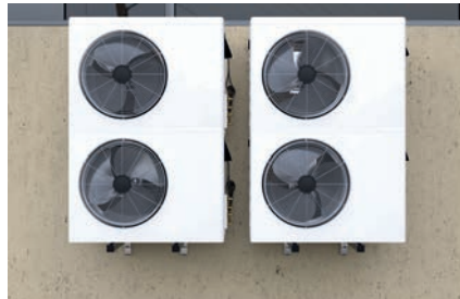
Unidades de aire acondicionado
