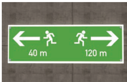
Señales de salida de emergencia en túneles
