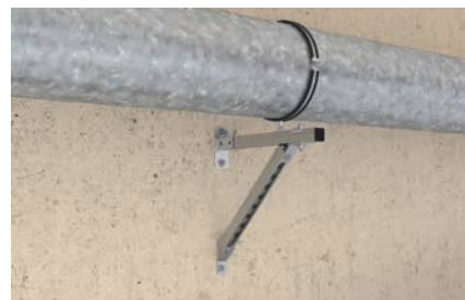
Conducto de aire en espiral en voladizo
