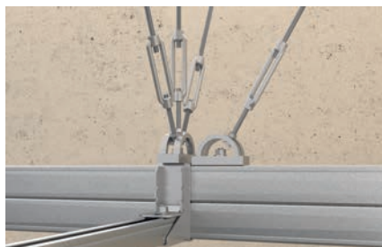
Refuerzo de carril para rejilla de instalación
